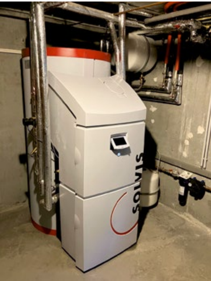
Die neue Heiztechnik nimmt im Keller weniger Platz ein und ist dank Wärmepumpe und Solarthermie-Anlage deutlich klimafreundlicher.
