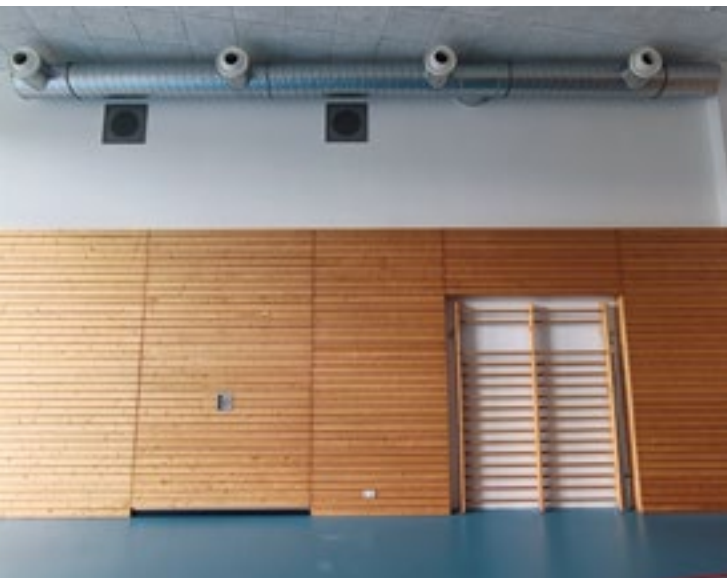
Installierte Raumluftanlage im Kindergarten Kinderreich in Zuzenhausen – auf dem Bild der Turnraum des Kindergartens.
