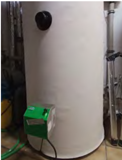
Der Warmwasserspeicher kann mit eigenem Solarstrom beheizt werden.
