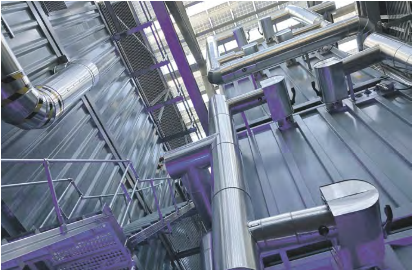
So sieht die Kältezentrale von innen aus: Im Vordergrund die Container mit den verschiedenen Komponenten der Anlage, im Hintergrund erkennt man die luftige Solarfassade mit den schräggestellten PV-Modulen. Foto: Georg Stier.
