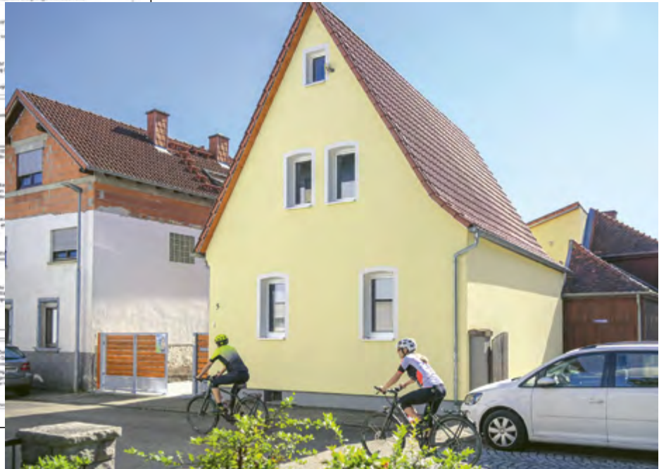
Das 120 Jahre alte spitzgiebelige Bauernhaus in Plankstadt umfassend saniert: das Dach gedämmt und neu gedeckt (zu der Zwischensparrendämmung erhielt es auf den Sparren 10 cm dicke Holzfaserplatten), die Außenwände rundum mit Mineralwolle gedämmt, dreifach verglaste Fenster eingebaut und der Energiebedarf um 70 Prozent reduziert.
