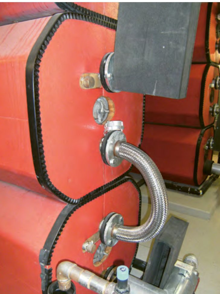
Erfolgreiche Revalidierung des Hallenbads Hasenleiser der Stadtwerke Heidelberg Bäder GmbH im Jahr 2023. Im Bild der Warmwasserspeicher.
