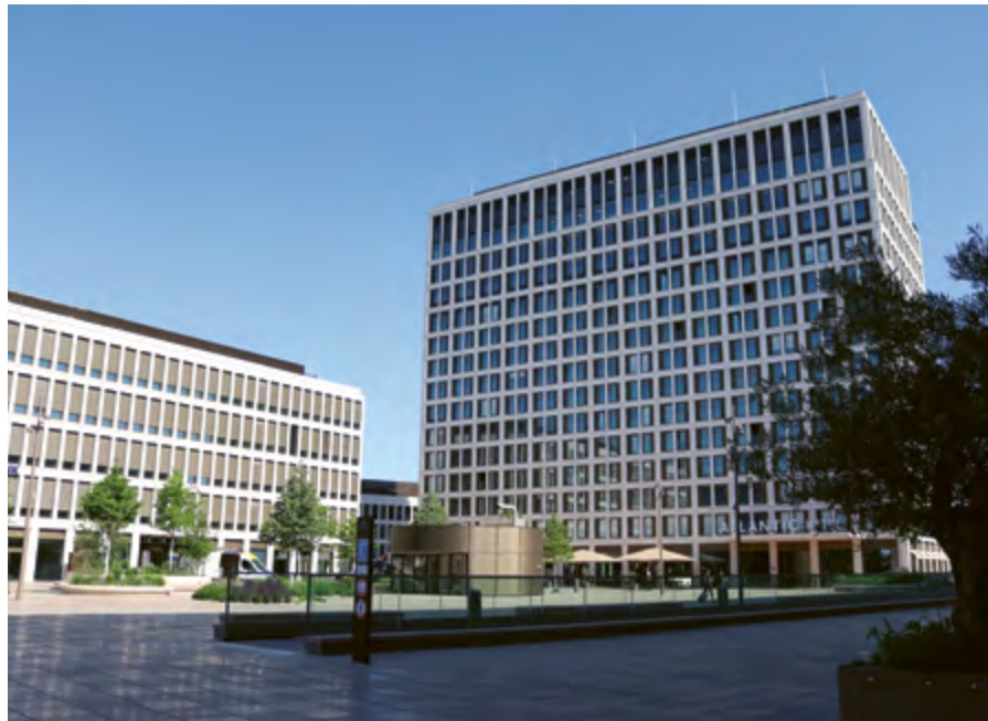
Das ATLANTIC-Hotel Heidelberg: Die vierzehnstöckige Fassade und Dämmung wurden mit Außenaufzügen fertiggestellt. Die KLiBA prüfte den Baufortschritt auch in luftiger Höhe.
